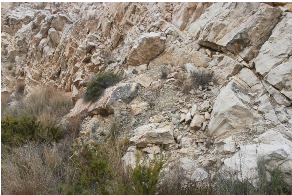
Fotografia 4. Acumulació de material al peu del talús.
