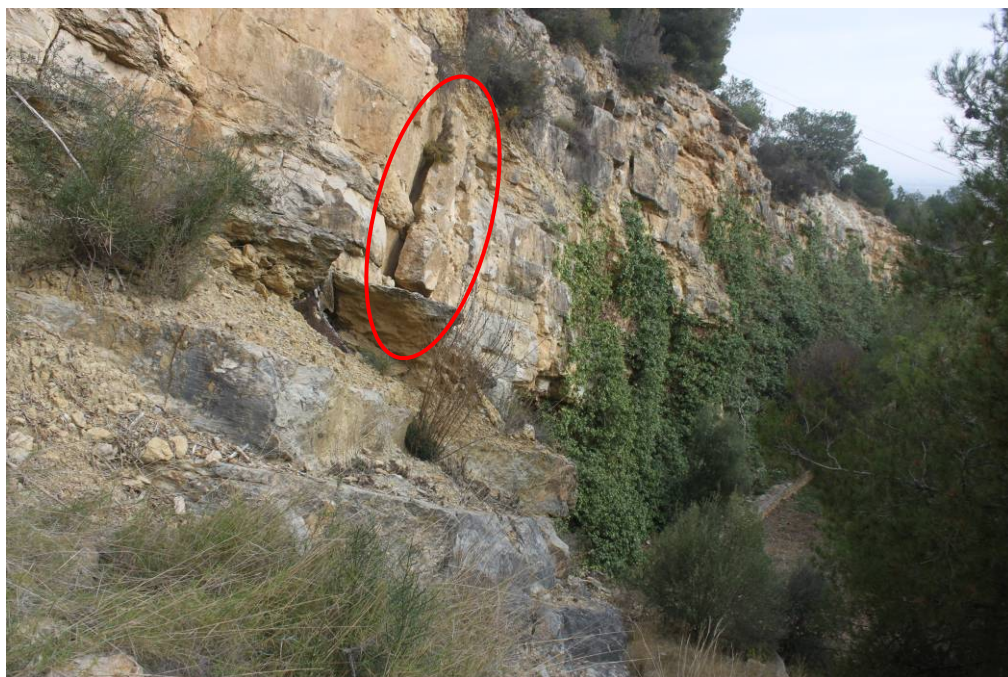
Fotografia 11. Volum potencialment inestable en l'escarpament per sobre del parc de la Glorieta.
